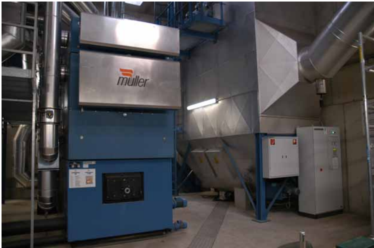
Heizung mit Elektrofilter (rechts), damit lässt sich auch Altholz sauber verbrennen.
